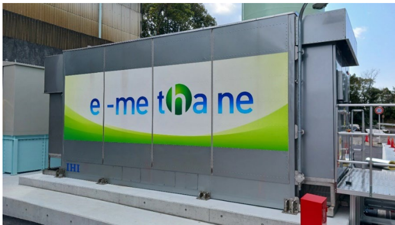
図 1-2-1 実証施設に納入したメタネーション標準機
