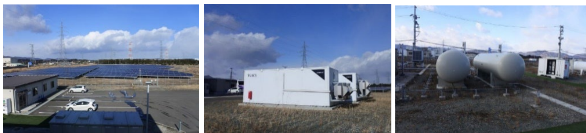
図 14. SIGC で運用する設備；左から太陽光発電、蓄電池システム、水素タンク
