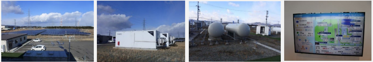
図 15. SIGC で運用する設備：左から 1.6MW の太陽光発電、蓄電池システム、水素タンク、エネルギーマネジメントシステムの画面
